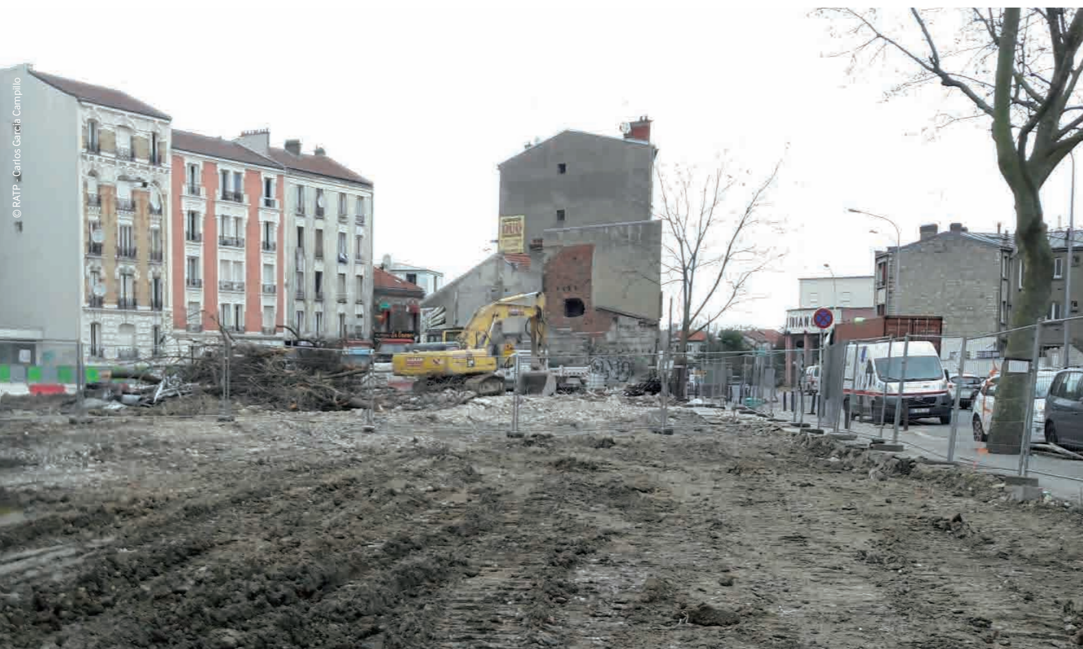
Le chantier du prolongement de la ligne 11 se met en place aux abords de la future station Place Carnot.
